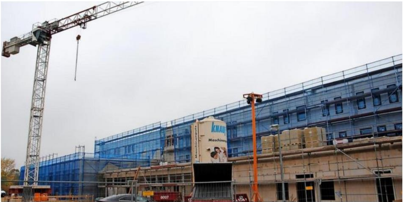
Der Rohbau der neuen Lehrter Feuerwache steht, aber die Fertigstellung verzögert sich enorm. Quelle: Achim Gückel
